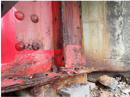
写真4-7 【損傷】主桁腐食、欠損
