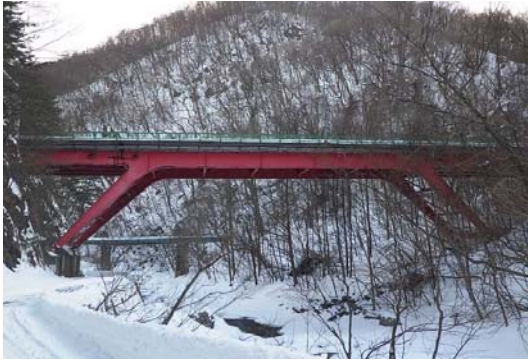
写真4-16 【損傷】 地覆の劣化・防護柵の腐食、 主桁防食機能の劣化
