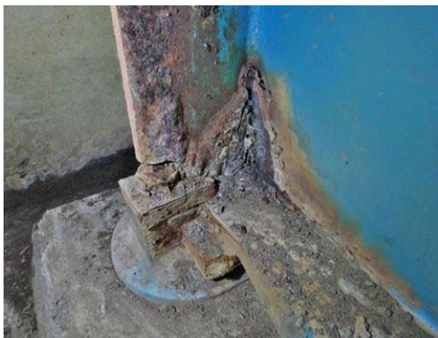
写真3-3 主桁端部の腐食
