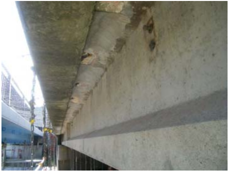
写真4-10 【損傷】 床版コンクリートの剥離・鉄筋露出
