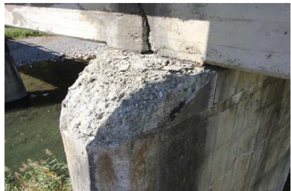
写真3-4 橋脚部コンクリートの剥離
