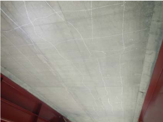
写真4-13 【損傷】床版の二方向ひびわれ
