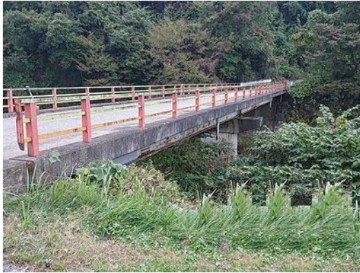
写真4-18 【損傷】 地覆の劣化・防護柵の腐食、 主桁防食機能の劣化
