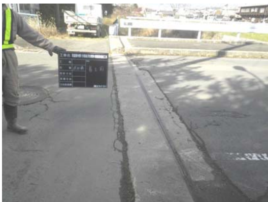
写真4-1 【損傷】 伸縮装置の劣化、橋面凸凹
