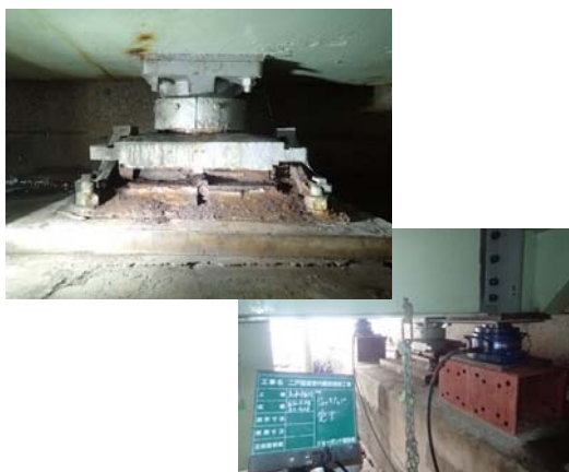
写真4-4 【損傷】 支承本体の機能障害、移動
